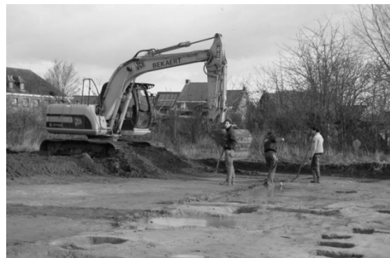
De aanleg van het opgravingsvlak met op de voorgrond de gecoupeerde kuilen van het Romeinse huis (IOED-TERF)
